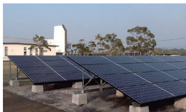
西都工場の敷地内に設置された太陽光パネル
